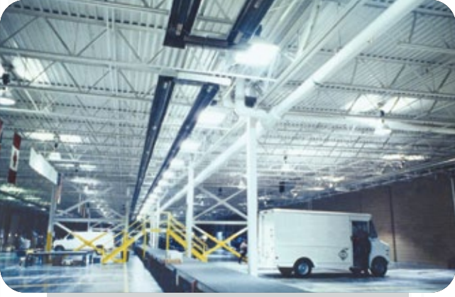
Depo Uygulaması: Seri Yakıclı Sistem - Genel Isıtma
